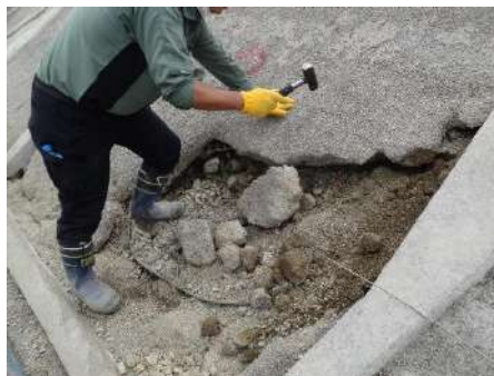
劣化状況②
