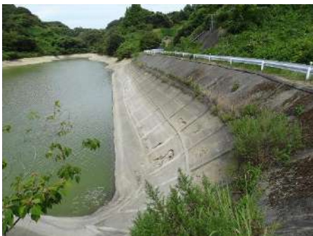
劣化状況①
